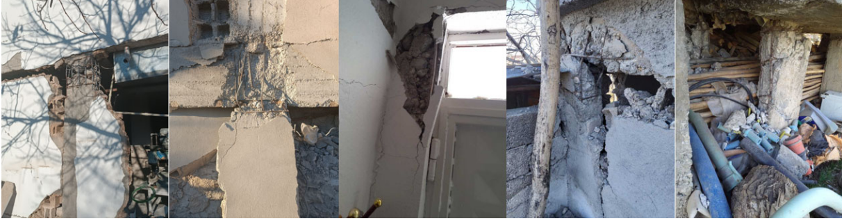
Şekil 6. Yetersiz donatı ve beton kaynaklı yapısal hasar örnekleri
