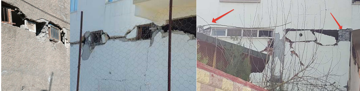
Şekil 4. BA yapılarda oluşan kısa kolon hasarları
